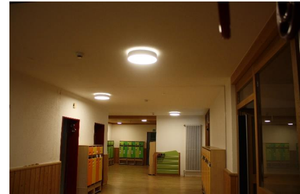
Neue Beleuchtung im Flur
