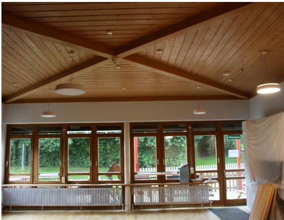
Neue Beleuchtung im Gruppenraum
